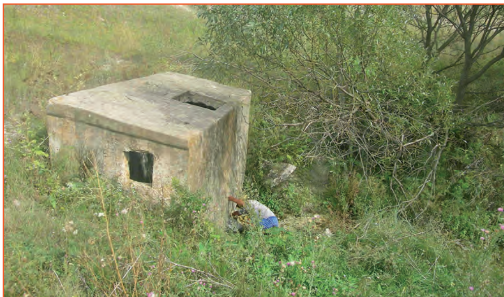
Бетонный каптаж, изготовленный на местности (фото из коллекции В.Е. Лаврова)
